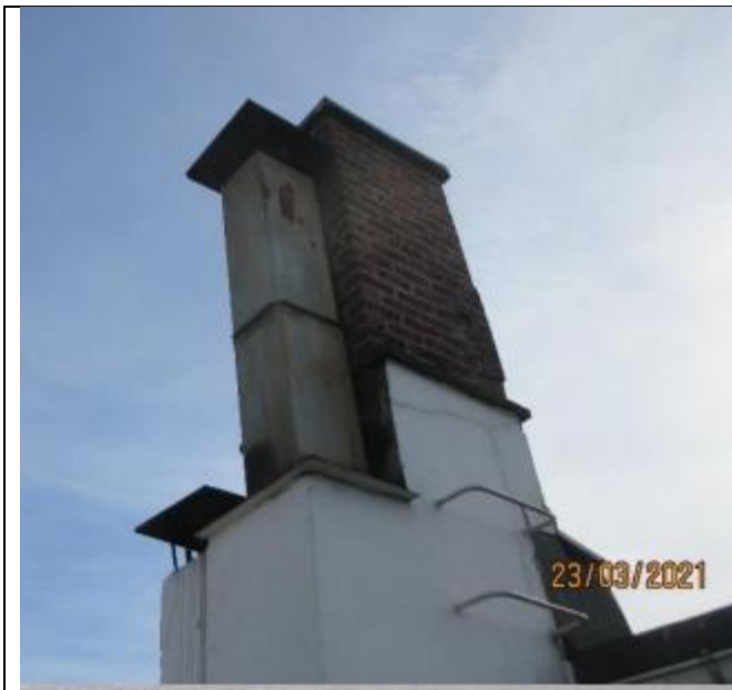
Sprekker i skorstein
